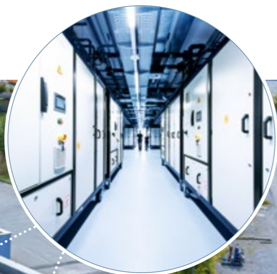
Batterietester und Batterietemperierung
